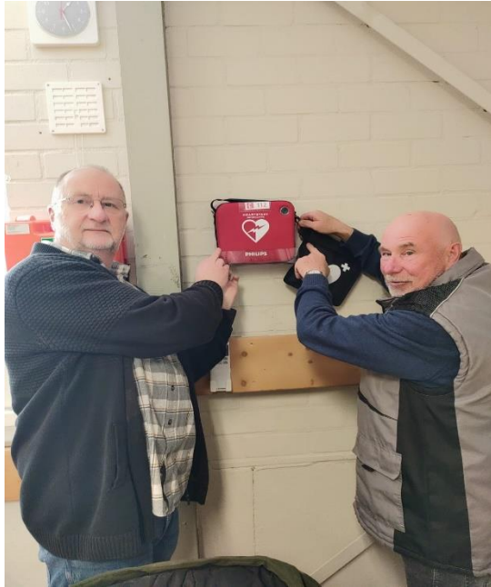
Het AED-apparaat geïnstalleerd.
